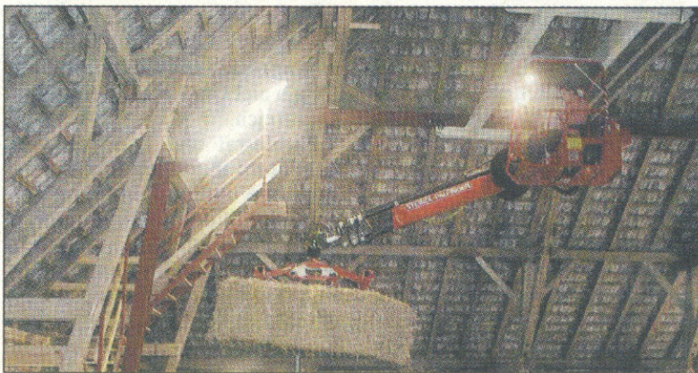
Strohlager und Förderband der Anlage werden mit einem Heukran beschickt. Fotos: Schachinger
